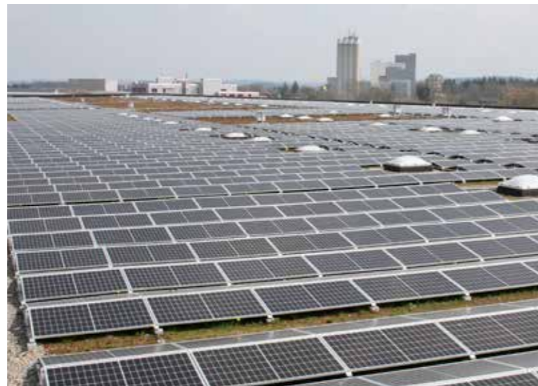
Die grösste PV-Anlage im Kanton Thurgau auf dem Dach des Lidl-Warenverteilzentrums in Weinfelden.
