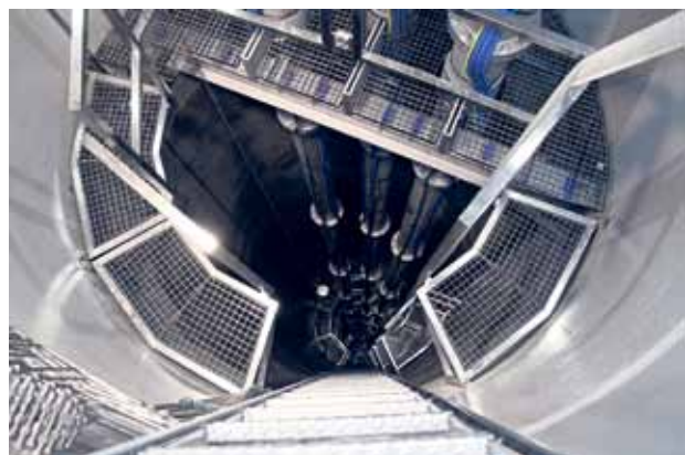
Das Pumpwerk, Herzstück der Weinfelder Wasserversorgung
